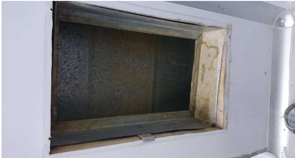
Falha de vedação entre duto de retorno e shaft de divisória - Fonte: Adrifercó
